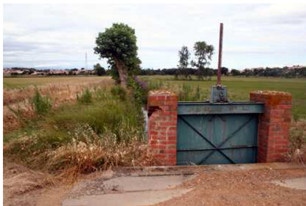
Photographie 15: La vanne du Correch avant sa bifurcation vers le tunnel
